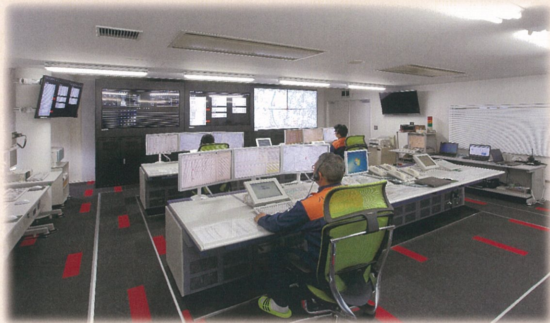
消防救急デジタル無線・高機能消防指令センター
