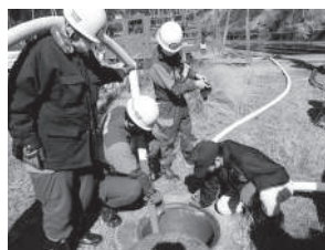
防火水槽への給水状況
