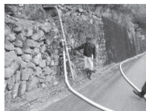
固定配管の機能テスト
